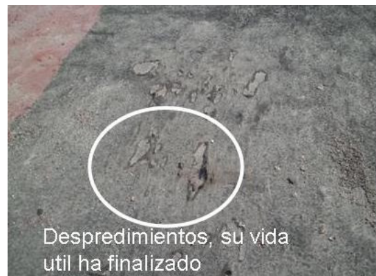
3.- La impermeabilizacion actual esta deteriorada porque su vida util ha llegado a su fin.
