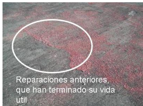
5.- Estas reparaciones han sido intemperizadas y su vida util tambien ha llegado a su fin.
