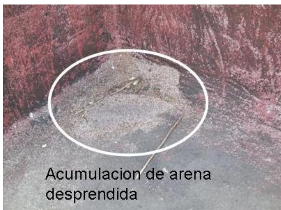
4.- Tenemos acumulacion de arena desprendida. Se han realizado algunos mantenimientos con arena cernida, pero esto no garantiza mucho.....
