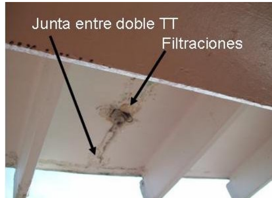
1.- La parte inferior de las losas presentan humedades.
