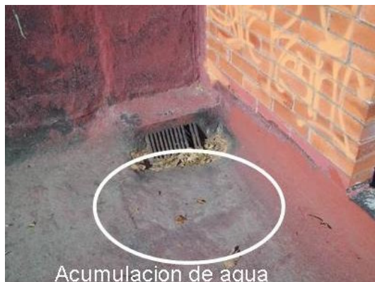
2.- El firme y relleno, posiblemente tenga algunos bados, en donde el agua pueda acumularse.
